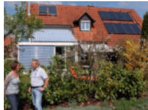
Die Kollektoren der Solarthermieanlage wurden in unverschatteter Süd-Ausrichtung installiert.
